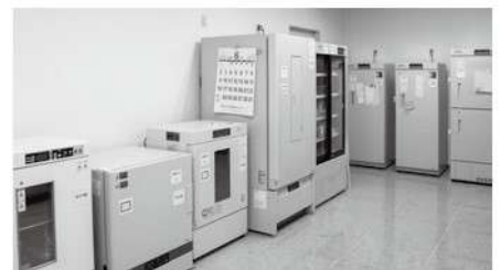
食品保管庫はニーズに応じて幅広い温度帯に対応
